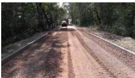
Fot. Prace drogowe na ul. Brukowej w Olesinie (odcinek na południe od autostrady A2)
