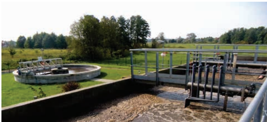
Fot.1 Reaktor biologiczny oraz osadnik wtórny
